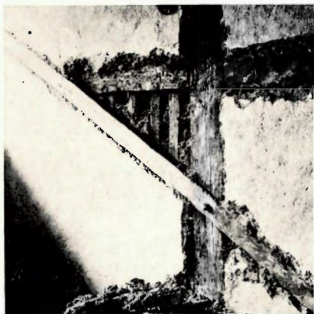
Fyrreranke ud for overetagen i vestforlængselsens vestgavl fotograferet under bygningsundersøgelsen i 1914. Bemærk de frilagte støjler og det tykke lag lerklining, der dækker bindingsværkets inderside. Lerklining, der også har dækket ranken, er delvis fjernet i forbindelse med undersøgelsen. Fot. i Nationalmuseets 2. afd.
